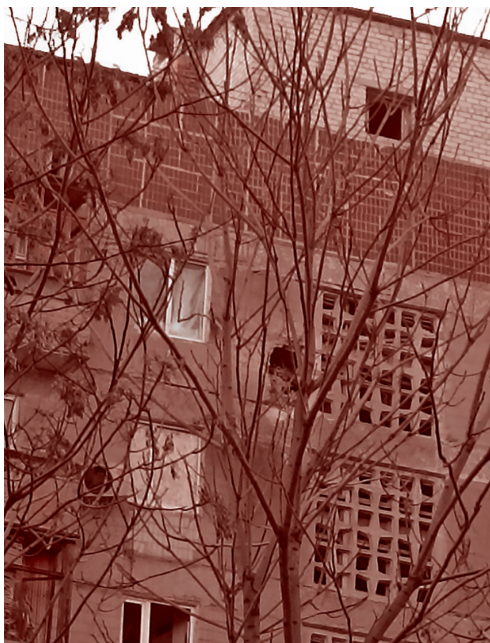
Последствия попадания снаряда в жилой дом
