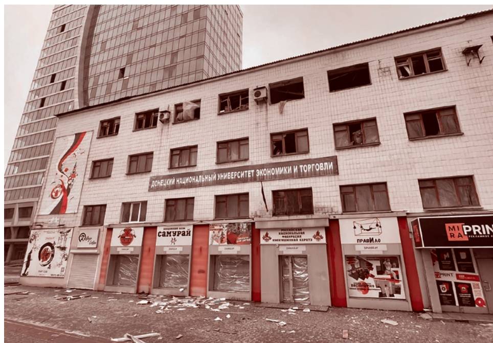
Повреждения корпуса Донецкого национального университета экономики и торговли
